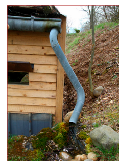
Point d'eau alimenté par l'eau du toit © J.F. Noblet
